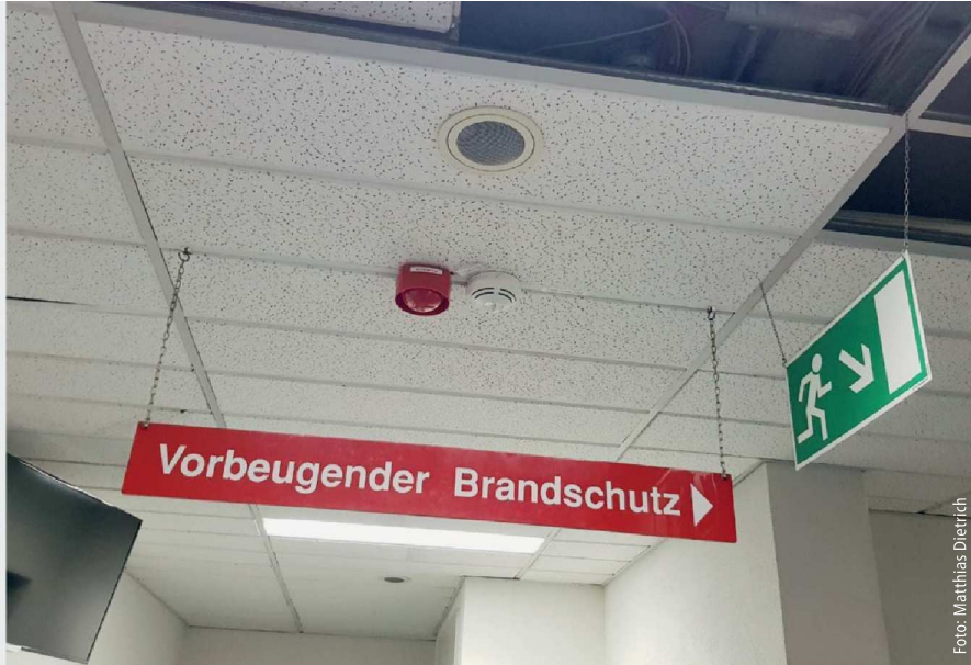
Ein guter vorbeugender Brandschutz zeichnet sich durch eine zielgerichtete und einzelfallbezogene Brandschutzfachplanung aus. Brandmeldeanlagen haben dabei eine wichtige Funktion.
