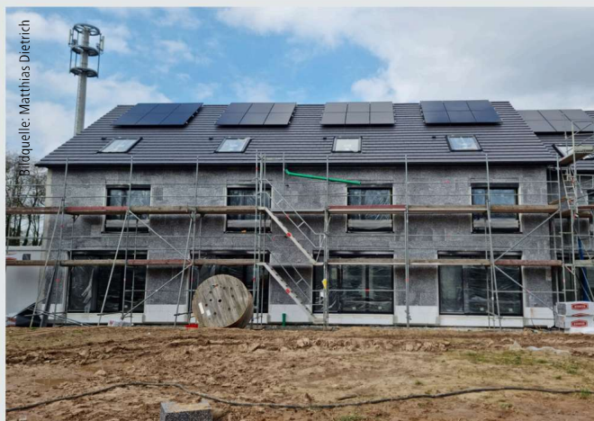
Die erforderlichen Mindestabstände zwischen PV-Anlagen und nicht über Dach geführten Brandwänden sind in der Bundesrepublik gegenwärtig völlig unterschiedlich geregelt.
